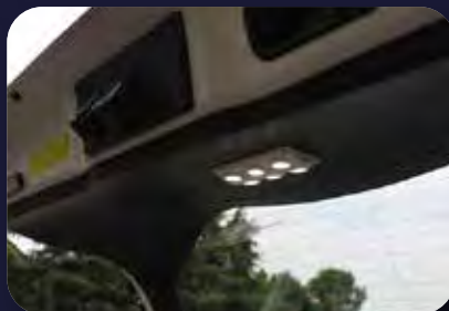
Plafoniera per illuminazione vano tecnico
